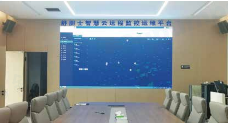
控制室远程监控运维平台
